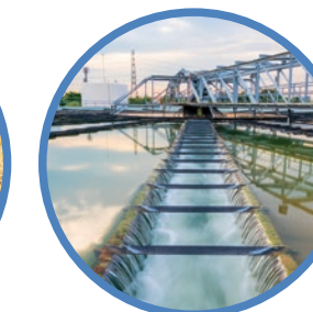
TRATAMIENTO DE AGUA
